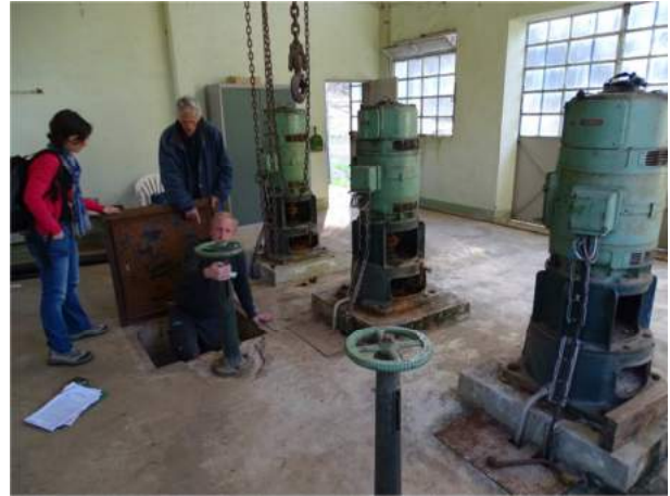
Local contenant les pompes
